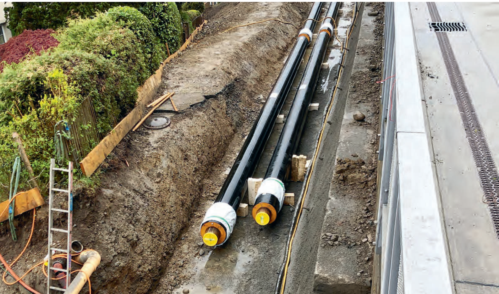
Wärmeleitungen beim Bahnhof Küssnacht am Rigi.
