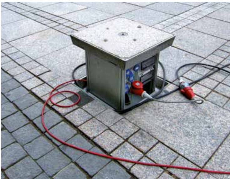
Senkelekrant mit Strom- und Wasseranschluss.
