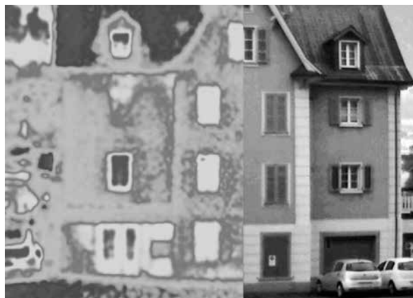
Wärmebildaufnahmen zeigen energetische Verbesserungsmöglichkeiten
