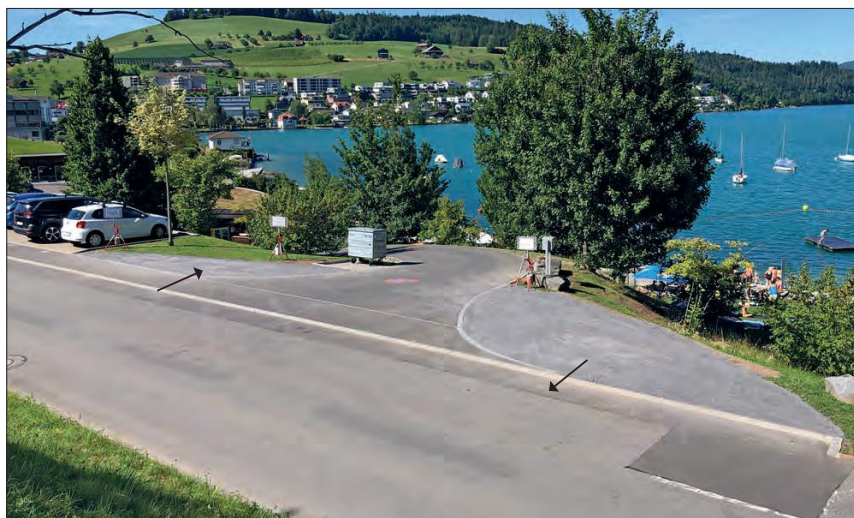
In der letzte Woche wurde beim Strandbad Staldenmatt in Immensee die provisorische Ein- und Ausladezone (Kiesflächen mit Pfeil) komplett erstellt.
