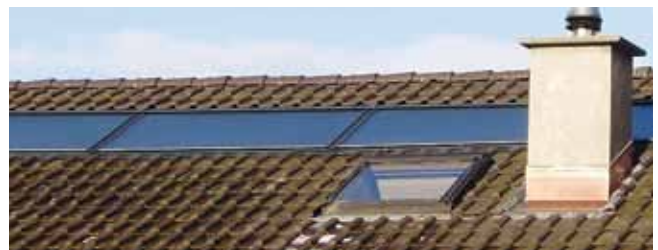
Beispiel von Sonnenkollektoren (Hofhalde, Küssnacht)
